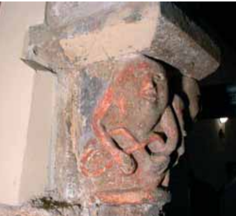
Capiteles antes del tratamiento. Repintes y añadidos de cemento ▼ Pórtland. Fotos: Jesús Puras Higuera.
