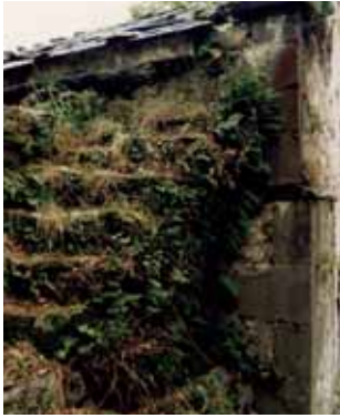
▲ Escaleras de acceso al campanario y a la cubierta. Foto: Carlos Ignacio Marqués Rodríguez.
