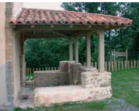
Arriba, pórtico de la iglesia una vez concluido el proceso de restauración. A la derecha, detalle de los muros, de los canchillos y de la cubierta. Fotos: Javier Arbesú Fanjul.
