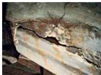
▲ Detalle de grieta cuya profundidad llega hasta el nervio. Foto: MC, Conservación y Restauración.
