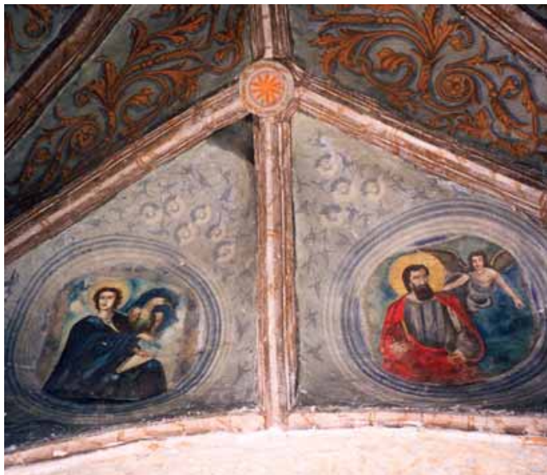
▲ Estado previo a la intervención. Foto: MC, Conservación y Restauración.
