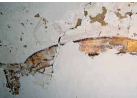
▲ Detalle, San Simón antes de la intervención. Foto: Magdalena Aguirregomezcorta.
